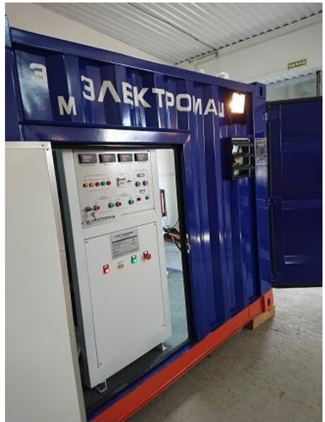
Вид сбоку корпуса- контейнера
