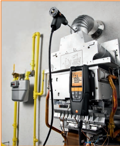
Измерение тяги дымовых газов с помощью testo 320.
