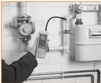
Рис. 26: Обнаружение утечки газа в трубах с помощью testo 316-1
