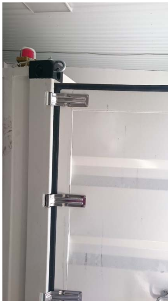
Сигнальная лампа при проведении высоковольтных испытаний
