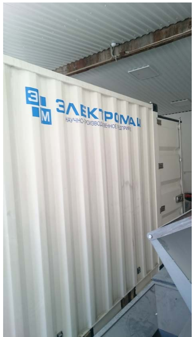
Вид сбоку корпуса- контейнера
