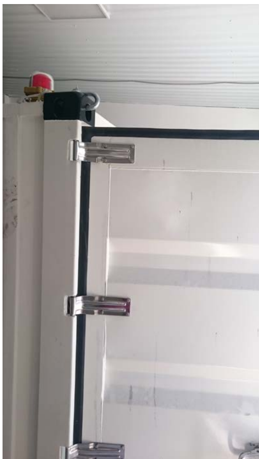
Сигнальная лампа при проведении высоковольтных испытаний
